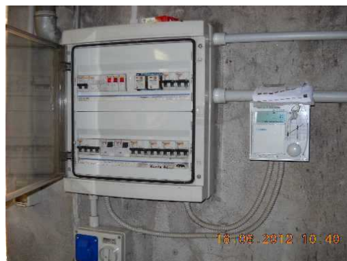
Quadro elettrico e gestione
