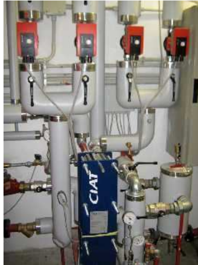
Collettore circuiti termici
