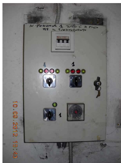
Quadro elettrico e gestione
