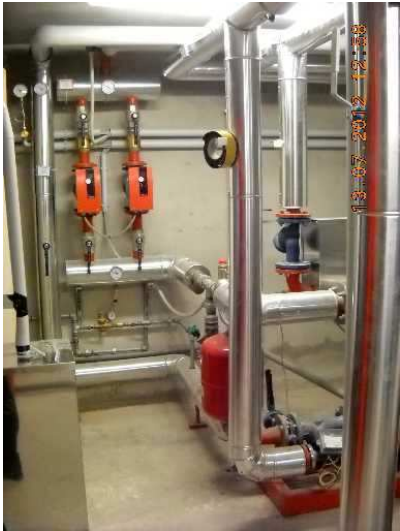
Collettore circuiti termici riscaldamento
