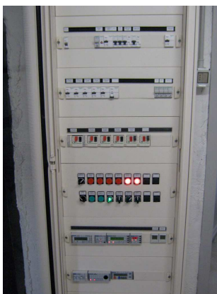
Quadro elettrico e gestione
