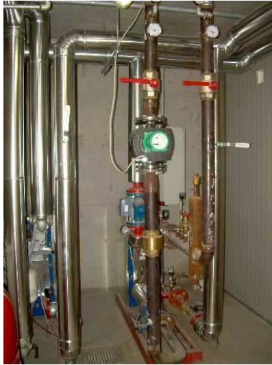
Generatori termici riscaldamento e sanitario da teleriscaldamento
