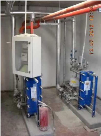
Generatori termici riscaldamento e sanitario da teleriscaldamento ed accumuli sanitario e solare
