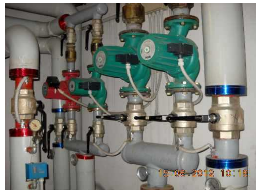
Collettore circuiti termici
