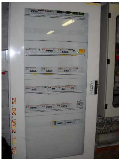
Quadro elettrico e gestione
