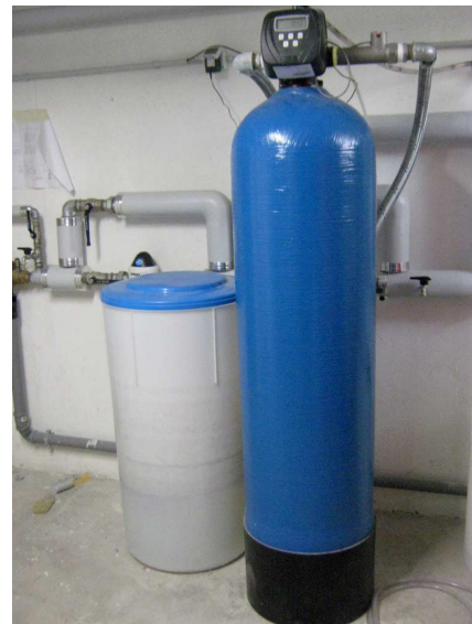
addolcimento e trattamento acque
