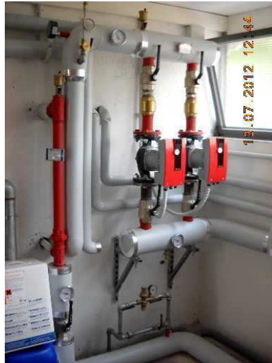
Collettore circuiti termici riscaldamento
