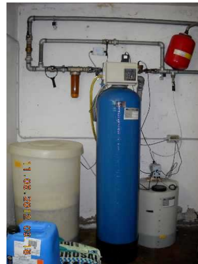
Gruppo dosaggio e filtraggio
