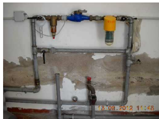
Gruppo dosaggio e filtraggio
