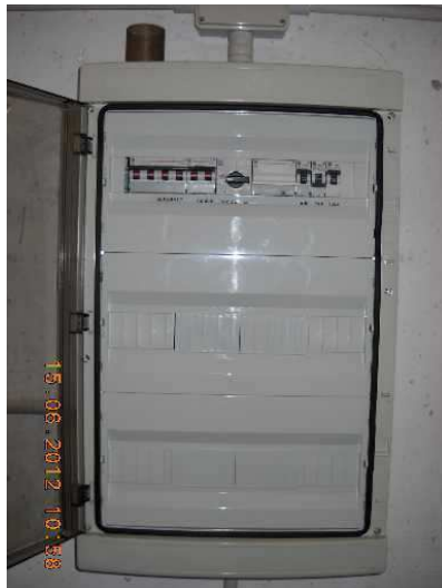
Quadro elettrico e gestione
