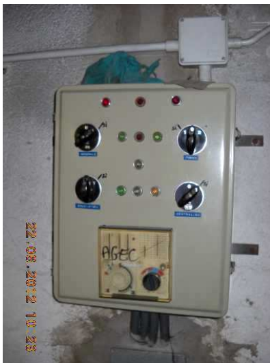
Quadro elettrico e gestione
