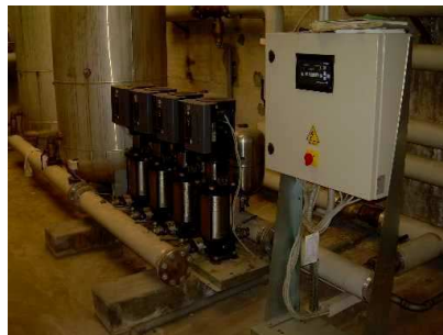
gruppo di pressurizzazione
