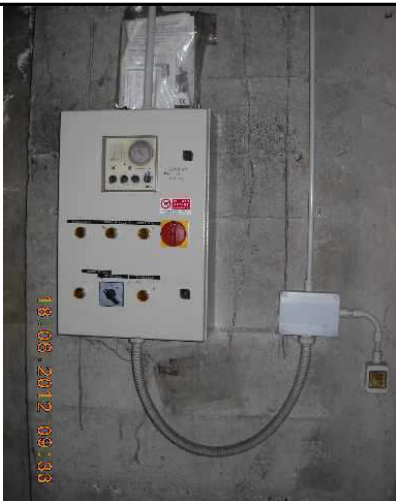
Quadro elettrico e gestione
