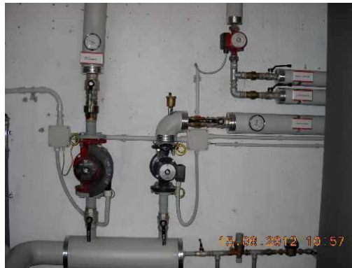
Collettore circuiti termici
