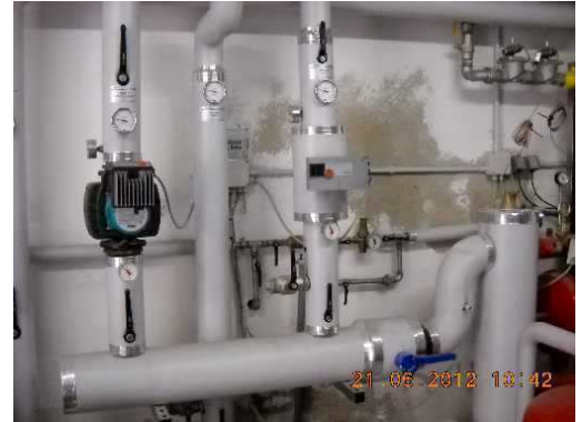
Collettore circuiti termici
