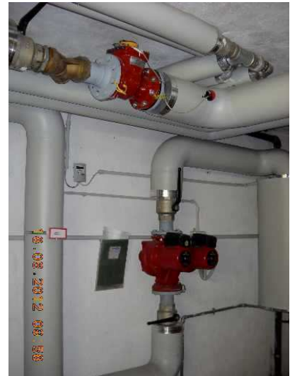
Collettore circuiti termici
