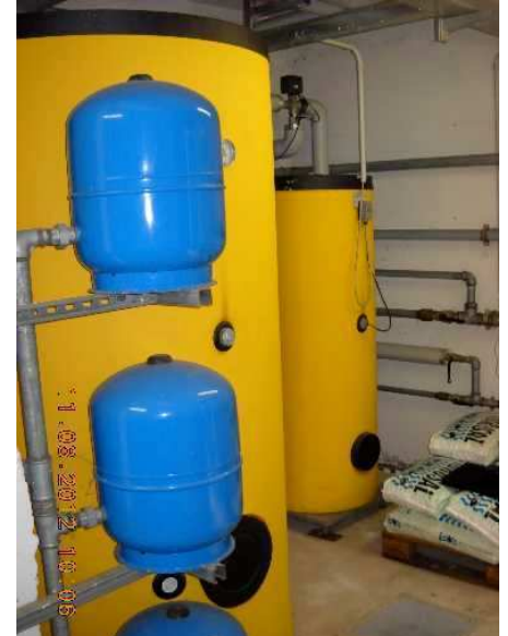
Apparecchiature di centrale
