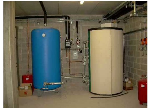
Accumulo solare e sanitario e circuiti solare
