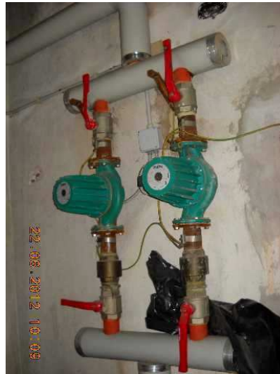
Collettore circuiti termici
