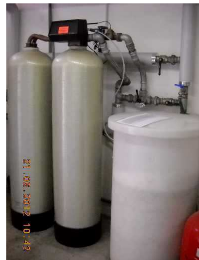
Gruppo di dosaggio ed addolcimento
