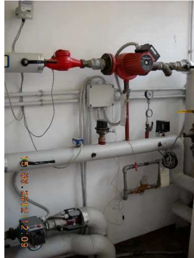
Apparecchiature di centrale
