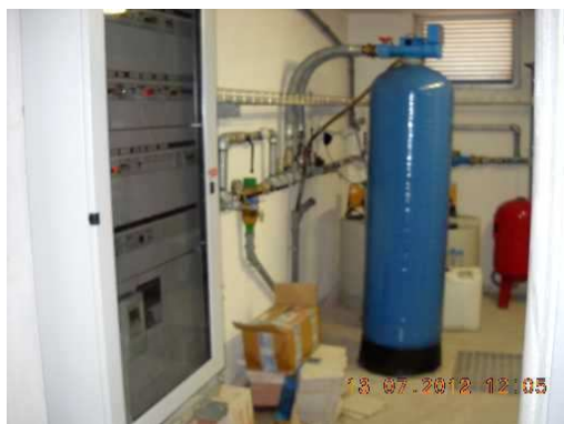
Quadro elettrico e gestione e gruppo addolcimento
