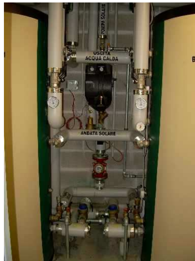
pompa solare e circuiti solare
