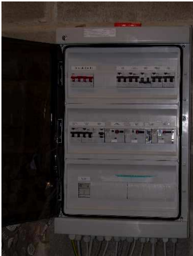
Quadro elettrico e gestione
