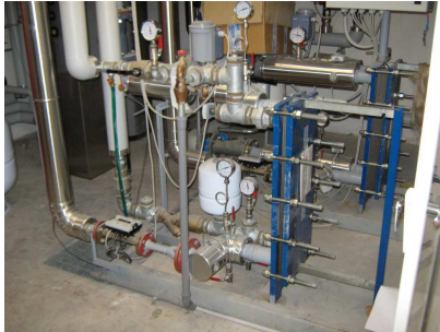
Generatori termici riscaldamento e sanitario
