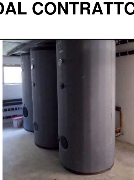
Accumuli sanitario e solare
