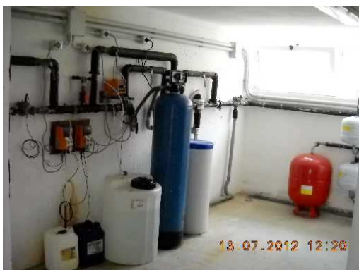
Gruppo addolcimento e dosaggio
