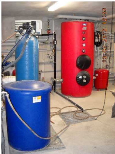
Accumulo solare e sanitario
