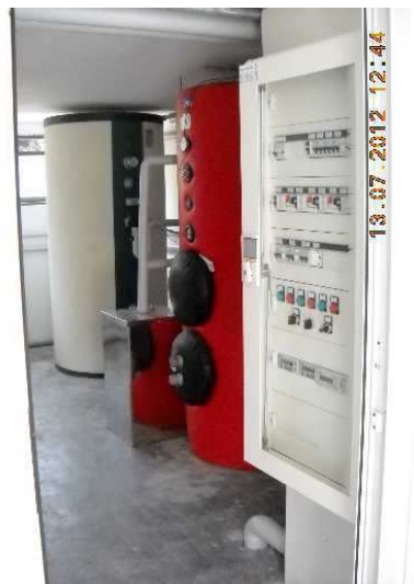
Quadro elettrico e gestione e accumuli solare e sanitario
