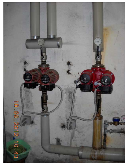
Collettore circuiti termici
