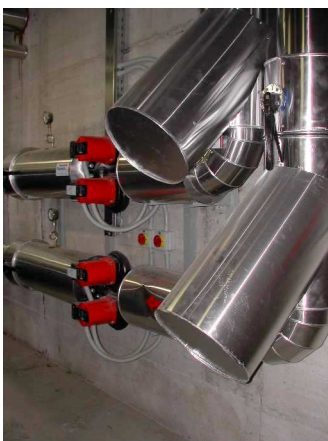
Pompe lato primario caldaie
