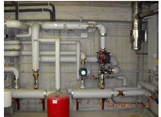
Collettore circuiti termici
