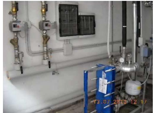
Collettore circuiti termici riscaldamento e Quadro elettrico e gestione
