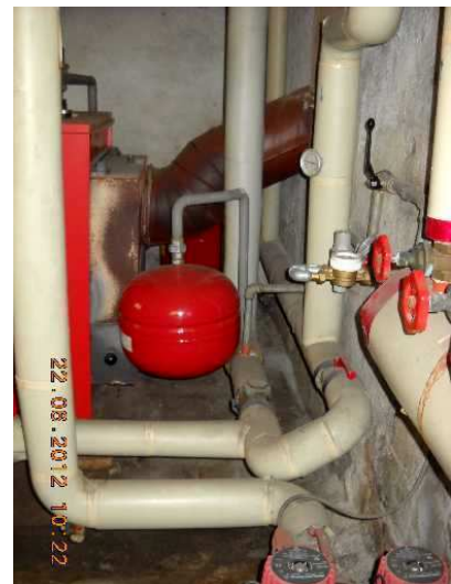
Apparecchiature di centrale
