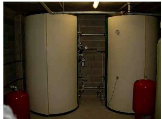
Accumulo solare e sanitario
