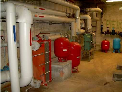
Scambiatori riscaldamento e sanitario da teleriscaldamento
