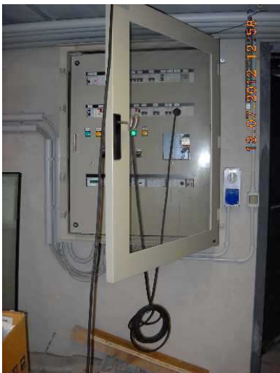
Quadro elettrico e gestione
