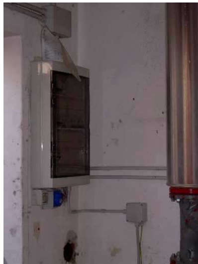
Quadro elettrico e gestione
