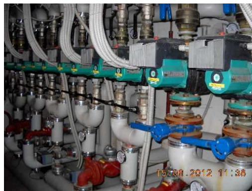
Collettore circuiti termici
