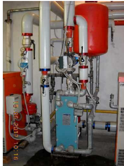
Apparecchiature di centrale
