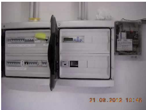
Quadro elettrico e gestione
