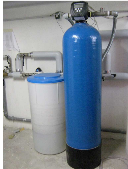
addolcimento e trattamento acque
