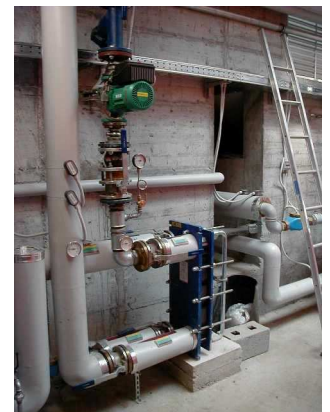
Pompa secondario solare e scambiatore solare
