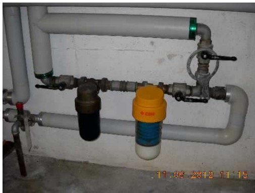
Gruppo dosaggio e filtraggio
