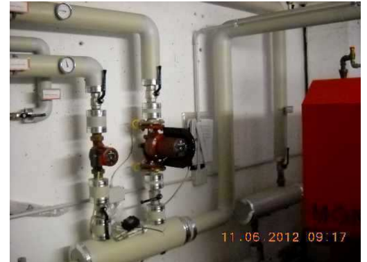
Collettore circuiti termici
