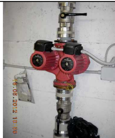
Collettore circuiti termici
