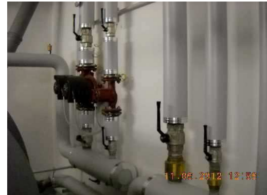
Collettore circuiti termici
