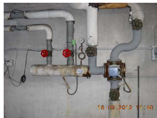
Collettore circuiti termici
