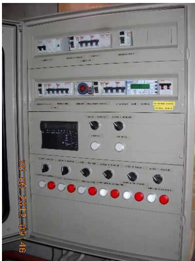
Quadro elettrico e gestione
