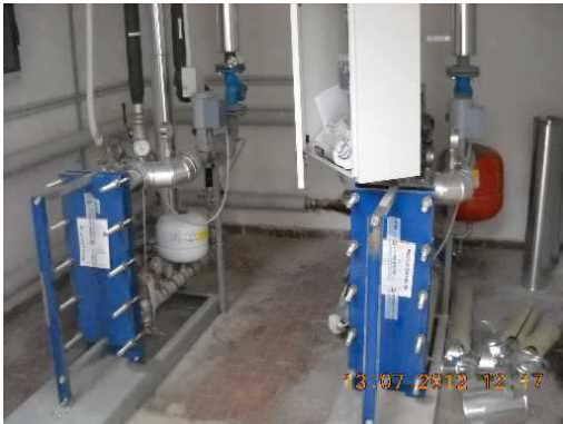
Generatori termici riscaldamento e sanitario da teleriscaldamento
