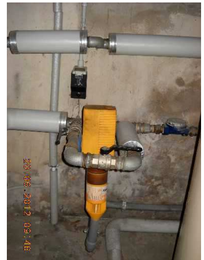
Apparecchiature di centrale
