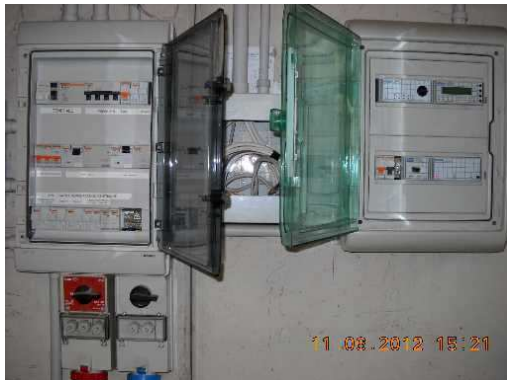
Quadro elettrico e gestione
