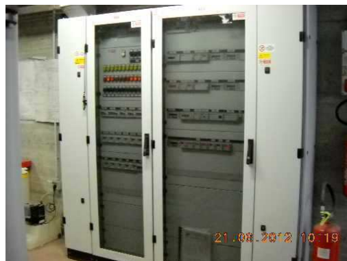
Quadro elettrico e gestione
