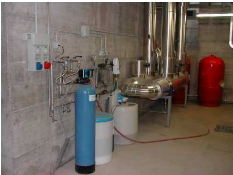
Gruppo di dosaggio ed addolcimento
