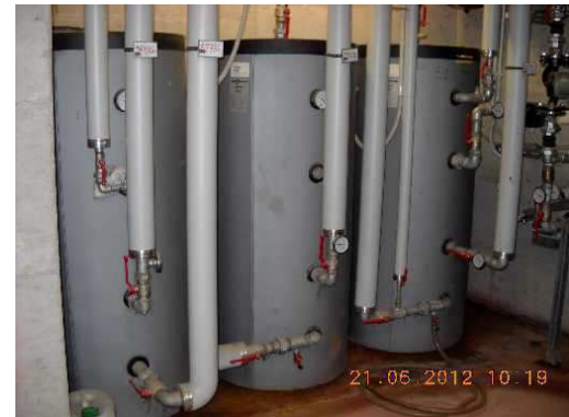
Accumulo sanitario e scambio solare
