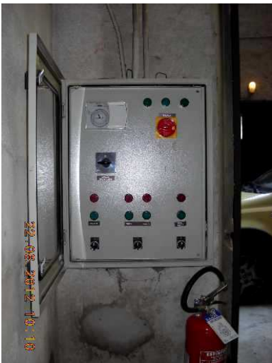
Quadro elettrico e gestione
