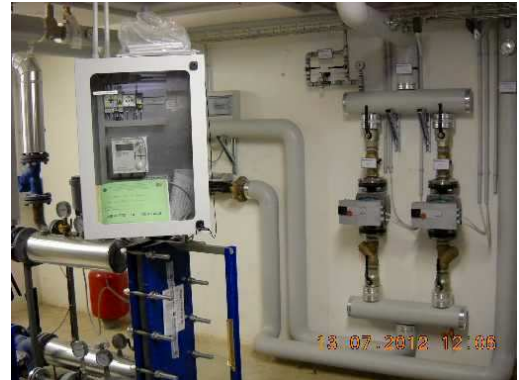
Collettore circuiti termici riscaldamento
