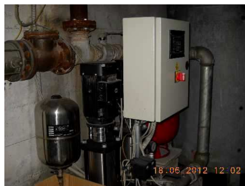
Gruppo di pressurizzazione
