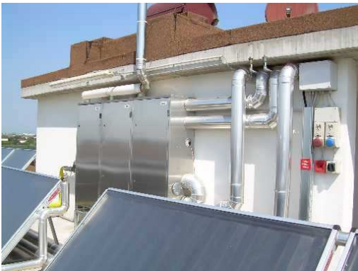
Generatori termici riscaldamento e sanitario
