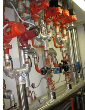
Collettore circuiti termici
