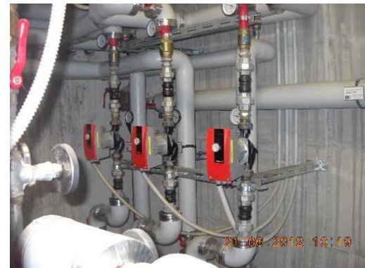
Collettore circuiti termici riscaldamento
