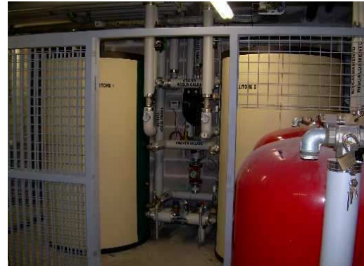
Accumulo solare e sanitario e circuiti solare
