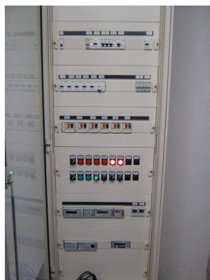
Quadro elettrico e gestione
