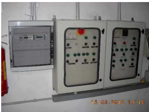
Quadro elettrico e gestione
