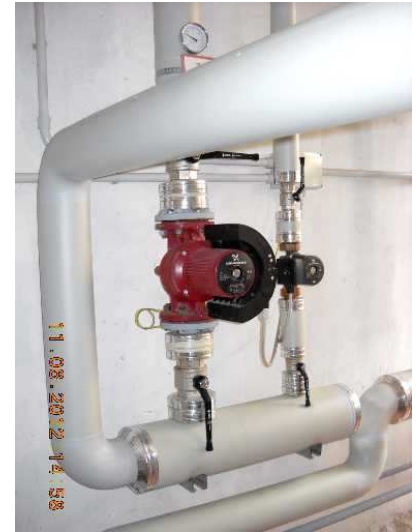
Collettore circuiti termici
