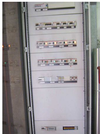
Quadro elettrico e gestione
