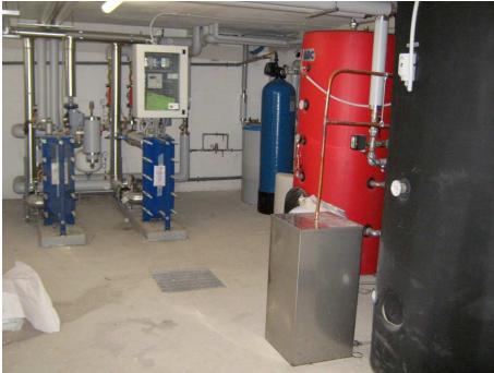
Generatori termici riscaldamento e sanitario
