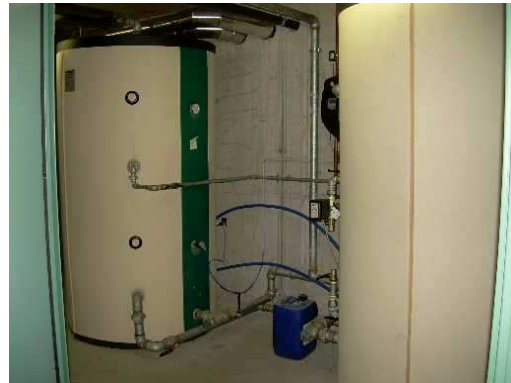
Accumulo solare e sanitario
