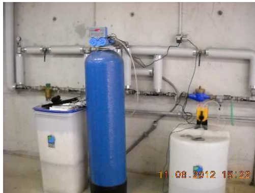
Gruppo di addolcimento e dosaggio
