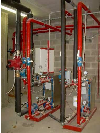
Generatori termici riscaldamento e sanitario da teleriscaldamento
