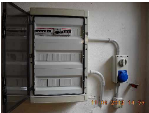
Quadro elettrico e gestione
