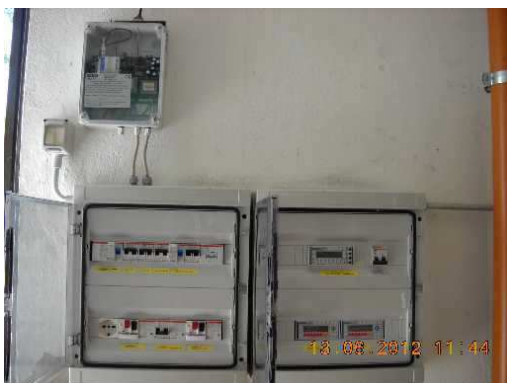
Quadro elettrico e gestione
