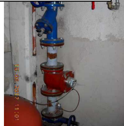
Collettore circuiti termici
