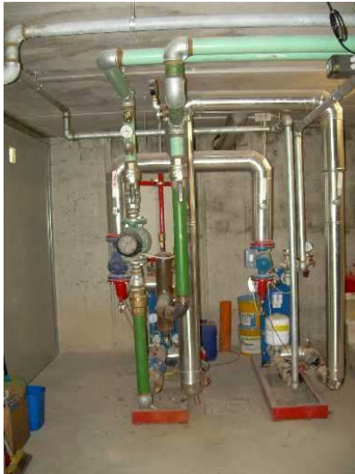
Generatori termici riscaldamento e sanitario da teleriscaldamento
