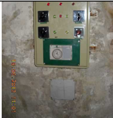
Quadro elettrico e gestione
