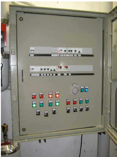
Quadro elettrico e gestione
