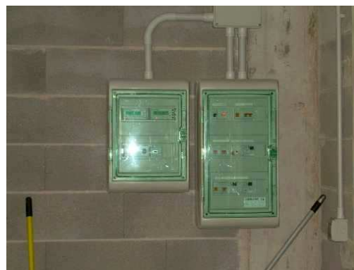
Quadro elettrico e gestione
