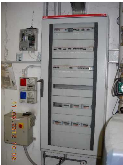
Quadro elettrico e gestione
