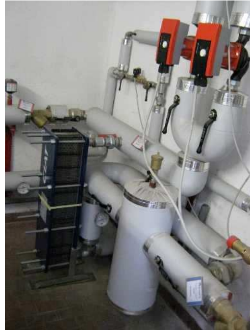
Collettore circuiti termici
