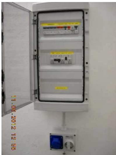
Quadro elettrico e gestione
