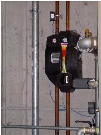
Pompa impianto solare
