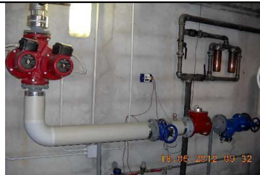
Collettore circuiti termici
