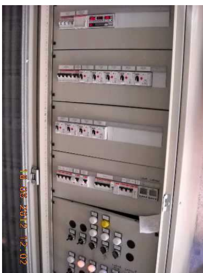
Quadro elettrico e gestione
