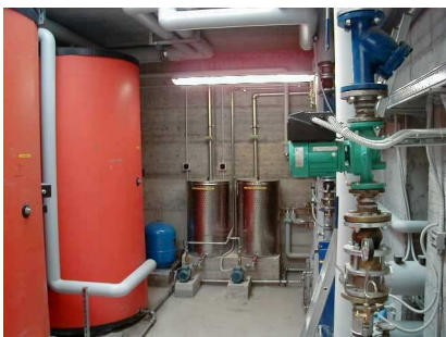
Circuito solare ed accumuli sanitario solare
