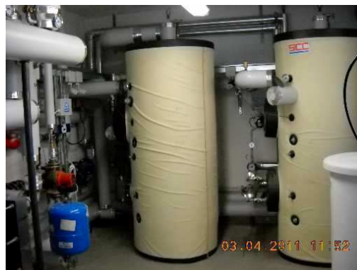
Accumulo solare e sanitario e circuiti solare
