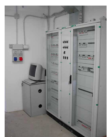
Quadro elettrico e gestione
