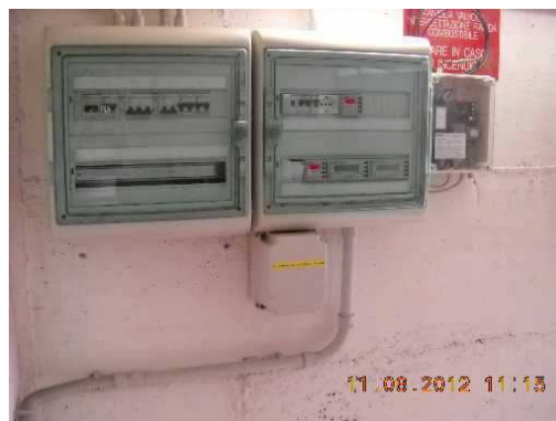
Quadro elettrico e gestione
