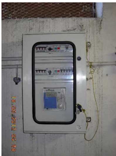
Quadro elettrico e gestione
