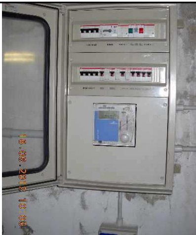
Quadro elettrico e gestione
