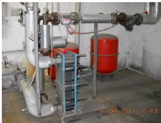
Scambiatore di calore
