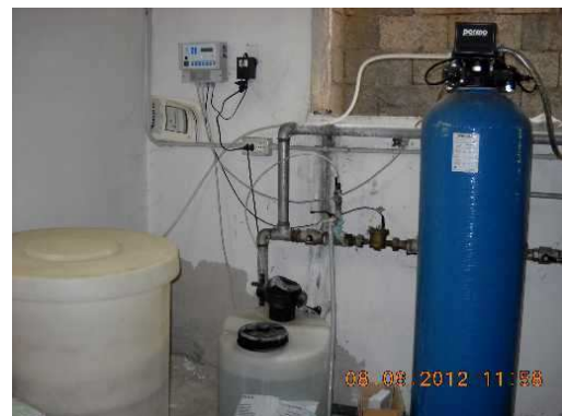
Gruppo dosaggio e filtraggio
