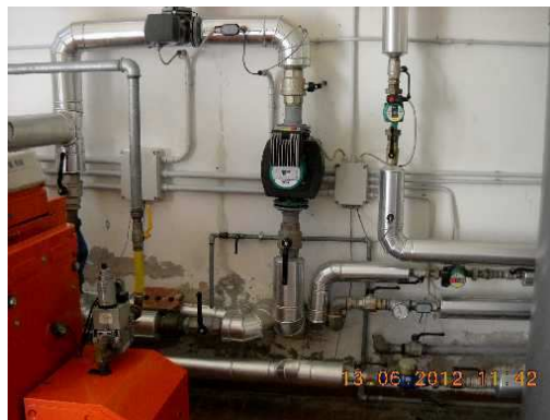
Collettore circuiti termici
