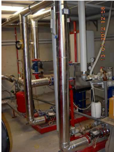
Generatori termici riscaldamento e sanitario da teleriscaldamento
