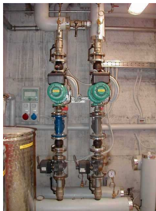
Pompe primario solare
