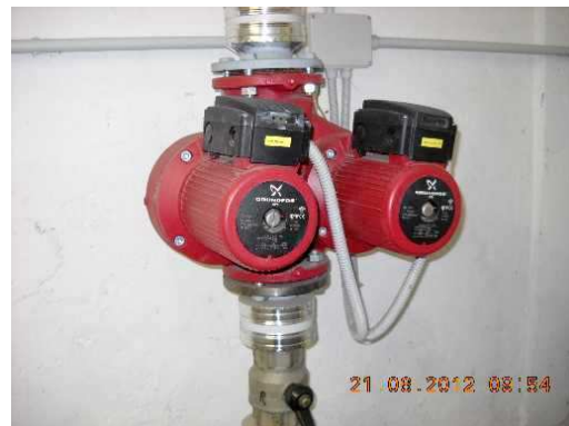
Collettore circuiti termici
