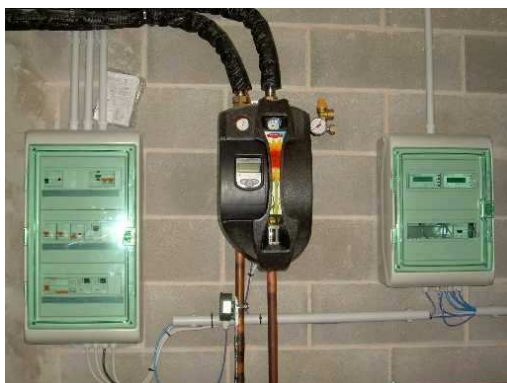
Quadro elettrico e gestione e pompa impianto solare
