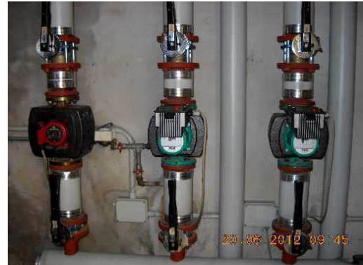
Collettore circuiti termici
