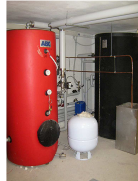
Accumulo solare e sanitario e circuito solare
