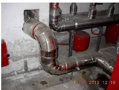
Apparecchiature di centrale
