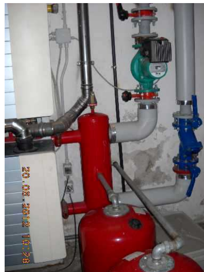
Collettore circuiti termici
