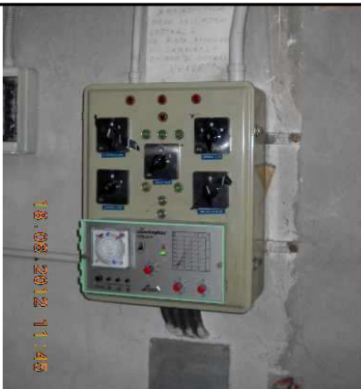
Quadro elettrico e gestione
