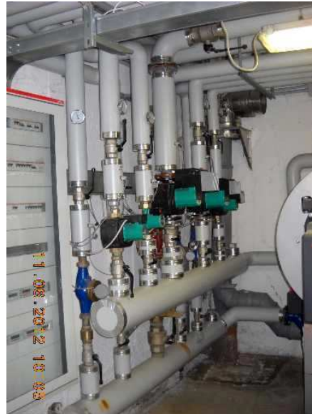
Collettore circuiti termici
