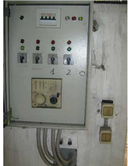
Quadro elettrico e gestione
