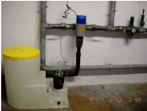
Gruppo dosaggio e filtraggio
