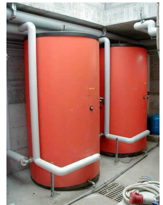
accumuli sanitario solare
