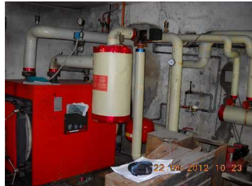
Apparecchiature di centrale
