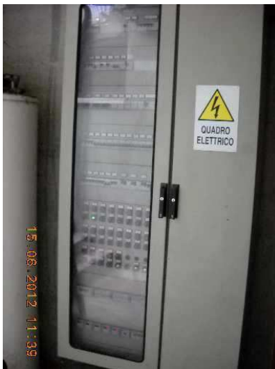
Quadro elettrico e gestione
