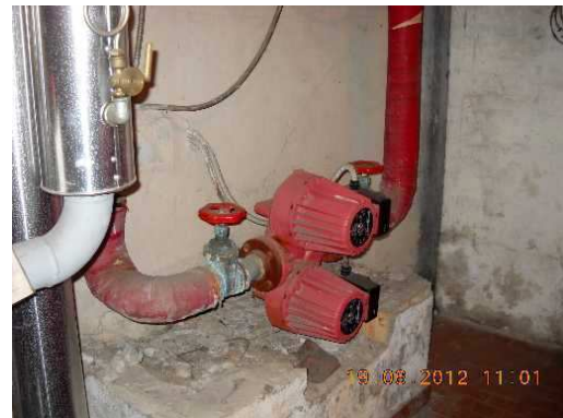
Collettore circuiti termici
