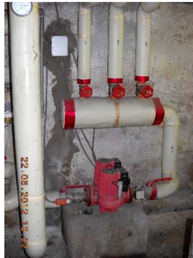
Collettore circuiti termici
