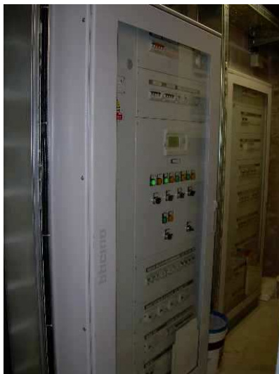
Quadro elettrico e gestione
