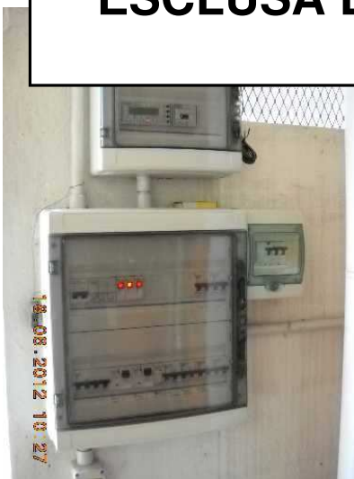
Quadro elettrico e gestione
