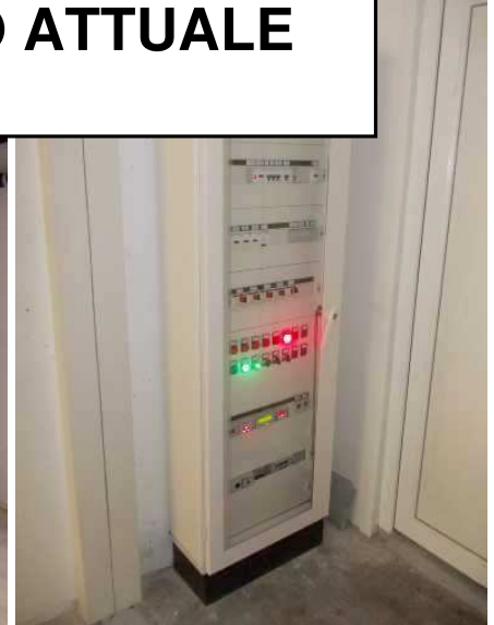
Quadro elettrico e gestione
