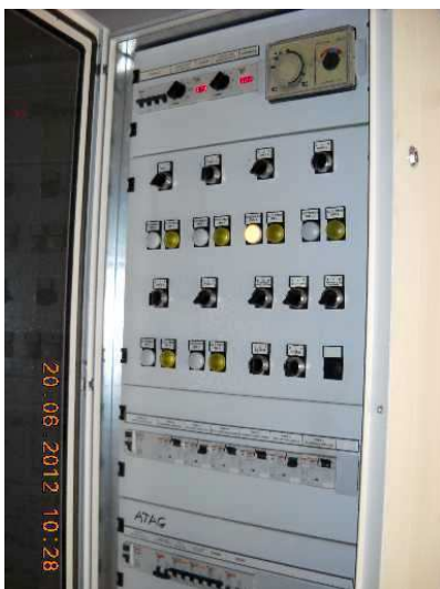
Quadro elettrico e gestione
