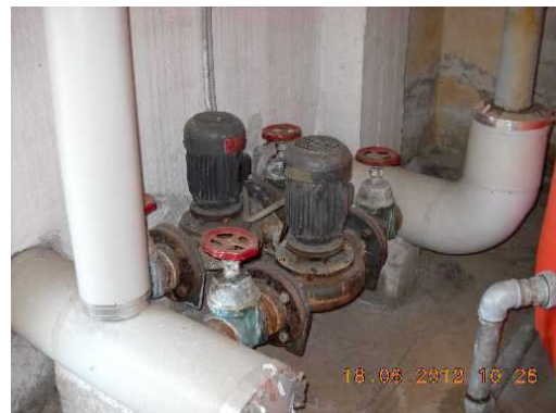
Collettore circuiti termici
