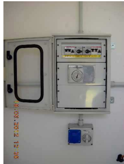
Quadro elettrico e gestione
