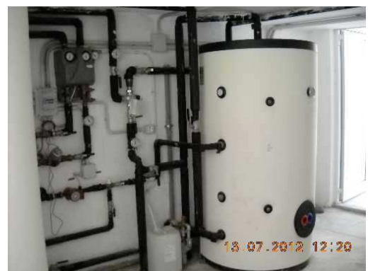
Accumulo sanitario e pompa solare
