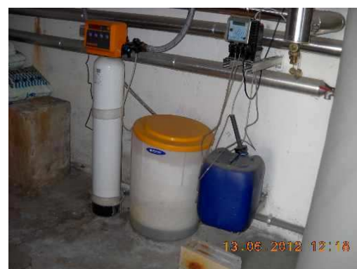
Gruppo dosaggio e filtraggio
