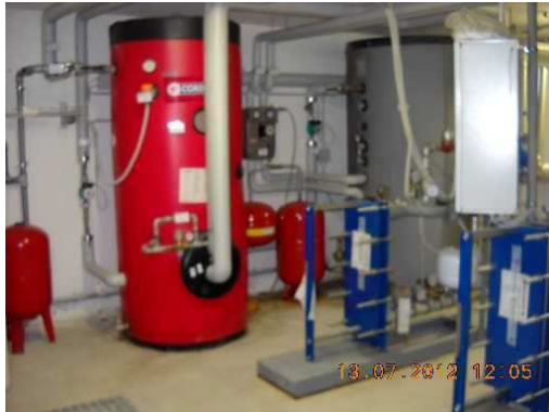
Generatori termici riscaldamento e sanitario da teleriscaldamento ed accumuli sanitario e solare
