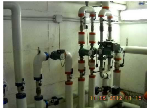
Collettore circuiti termici
