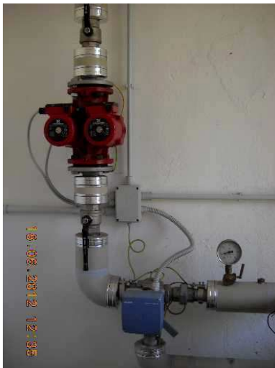
Collettore circuiti termici
