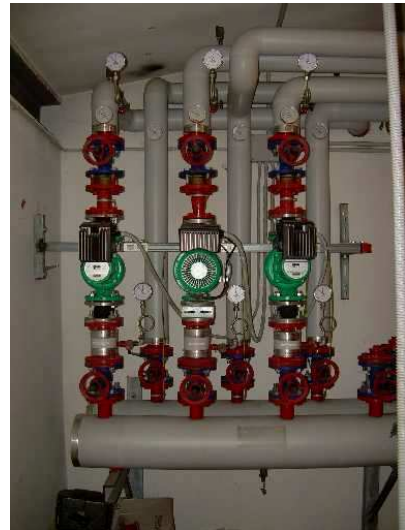
Collettore circuiti termici
