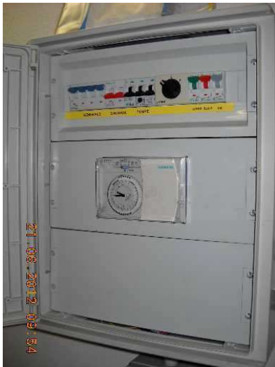
Quadro elettrico e gestione
