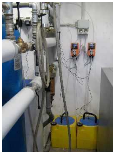
Gruppo dosaggio e filtraggio
