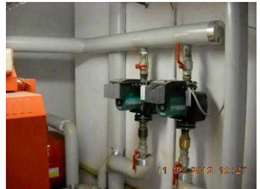
Collettore circuiti termici
