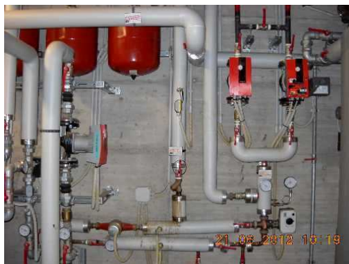
Collettore circuiti termici solare
