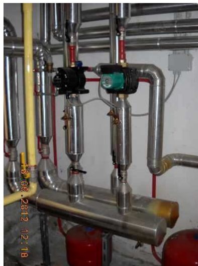
Collettore circuiti termici
